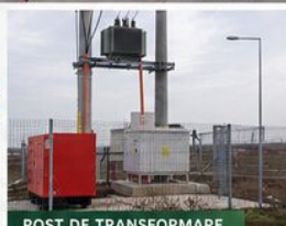
POST DE TRANSFORMARE
